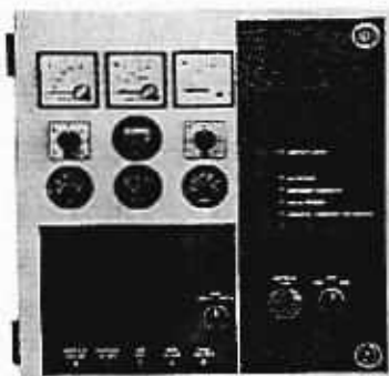
Fig. 10 Tablero de control
