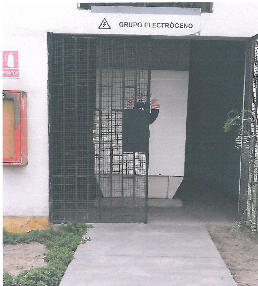
Imagen 2: Ubicación del grupo electrógeno
