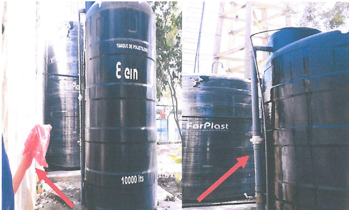
Imagen 7: Tanques de agua
