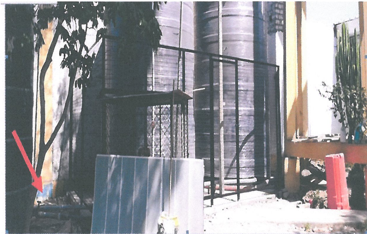
Imagen 6: Tanques de agua.
