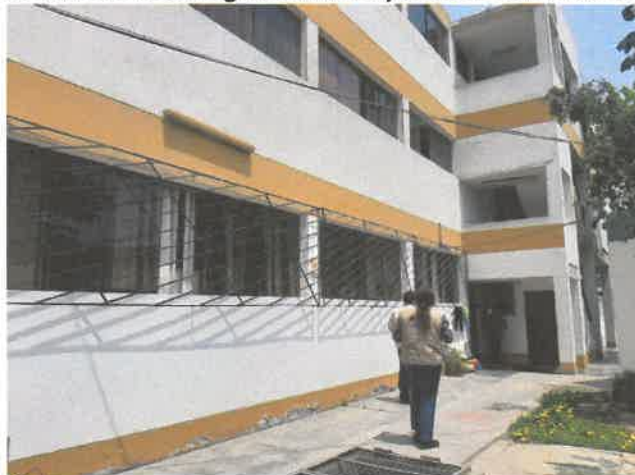
Lunas pegadas a columnas que pueden provocar columna corta
