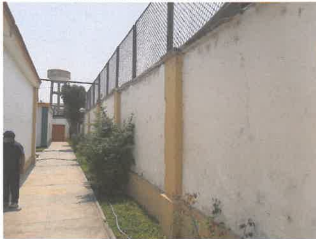
Cerco perimétrico colindante sin viga de amarre y existe área verde colindante al cerco.
