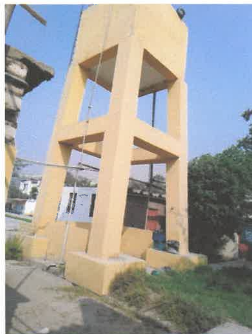
Tanque elevado de agua sin escalera de gato
