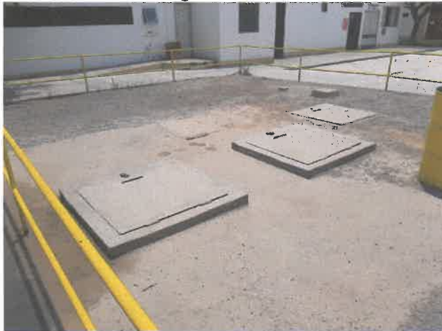
Tanque de combustible de petróleo para calderos.
