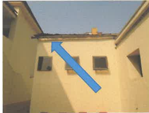
Canaletas del sistema de drenaje pluvial se encuentra en mal estado requiriendo mantenimiento
