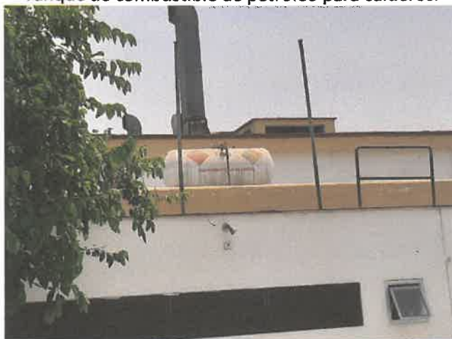
Tanque de GLP para cocina cerca del tanque de petróleo
