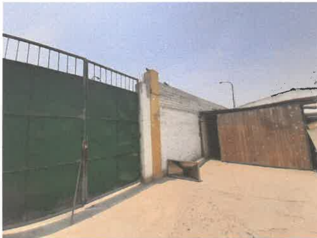
Cerco perimétrico colindante sin viga de amarre cerca de ambientes de almacén.
