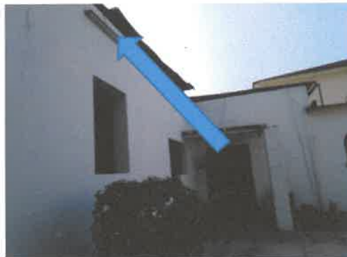
Cableado de baja tensión expuesto sin canalizar
