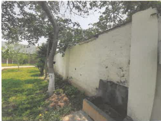
Área verde colindante a cerco perimétrico que no tiene viga de amarre.
