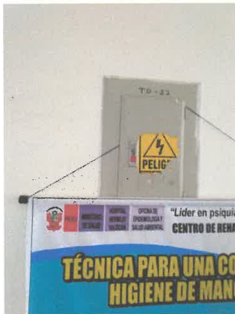
Sub tablero con señal de seguridad
