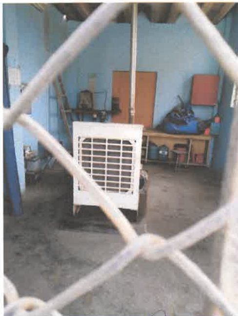
Grupo electrógeno protegido y operativo deteriorada
