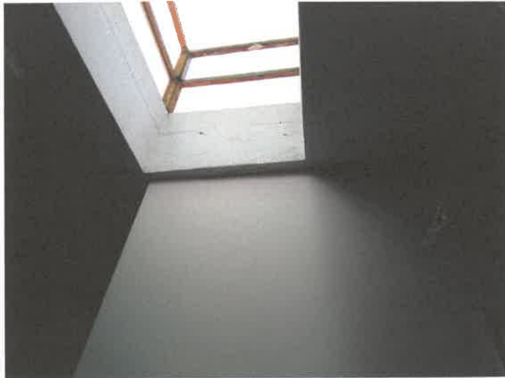
Grieta en viga en la edificación del servicio de emergencia
