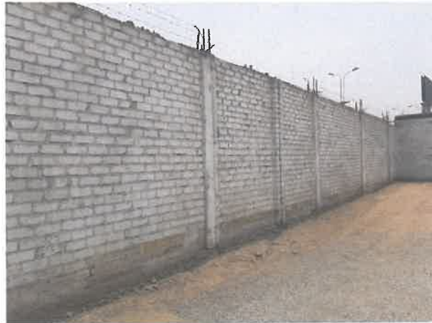
Cerco perimétrico colindante a la Av. La Cultura sin viga de amarre
