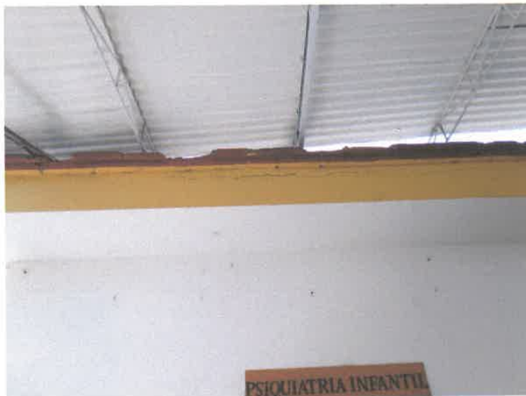
Grieta en viga en la edificación de psiquiatría infantil
