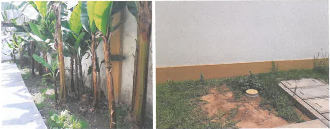
Área verde colindante al cerco perimétrico que propicia afloramiento de salitre
