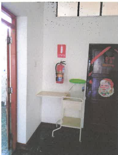
Extintores anclados y señalizados
