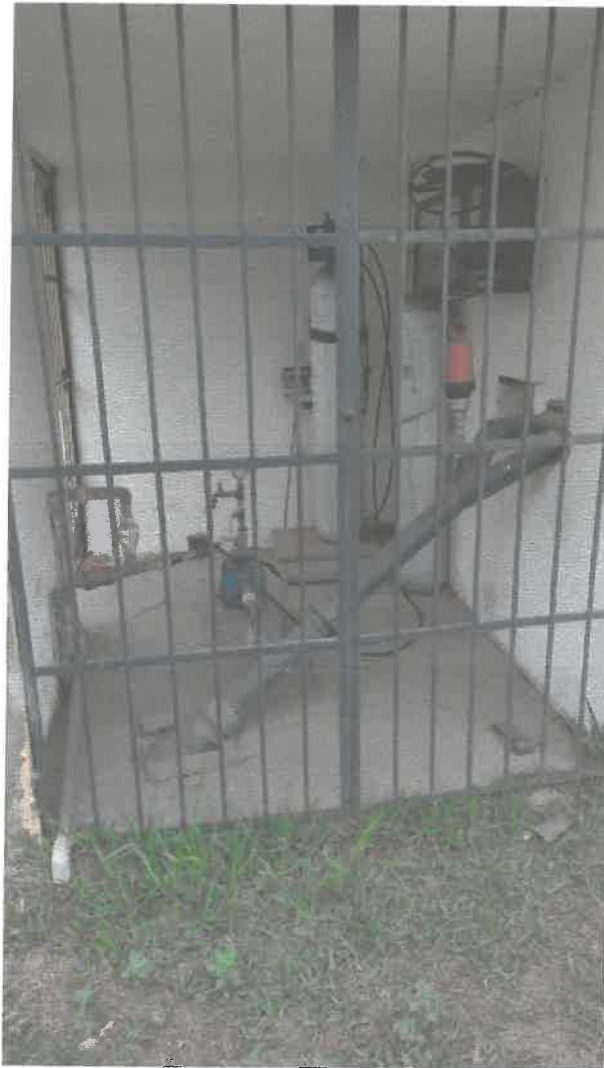
Sistema de Clorización
