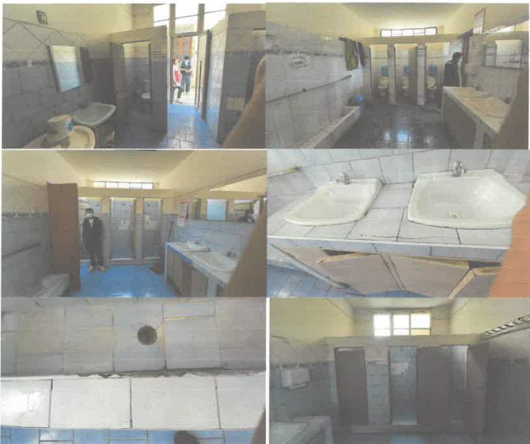
Estado actual de los baños y deterioro
