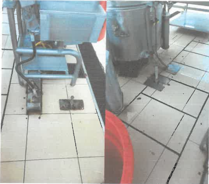
PISO DETERIORADO EN ÁREA DE MARMITAS
