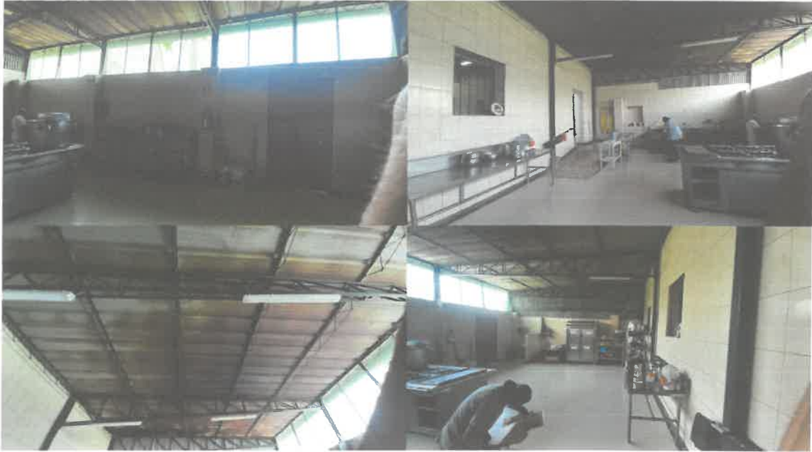
VISTA DE TECHO EN ESTADO DE DETERIORO EN COCINA DE CR ÑAÑA
