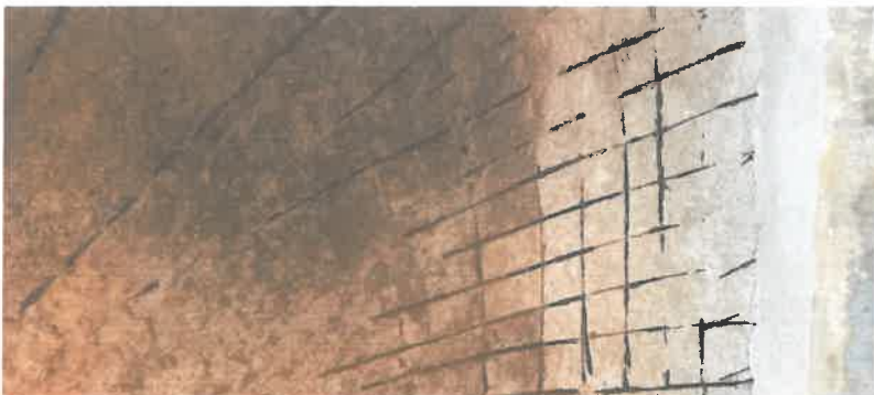
Vista del techo del tanque desde el interior donde se aprecia el deterioro
