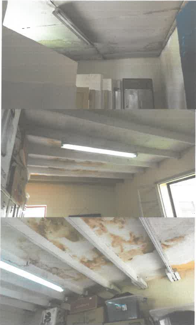
VISTA DE TECHO EN ESTADO DE DETERIORO EN VESTIDORES DE TÉCNICOS DE NUTRICIÓN
